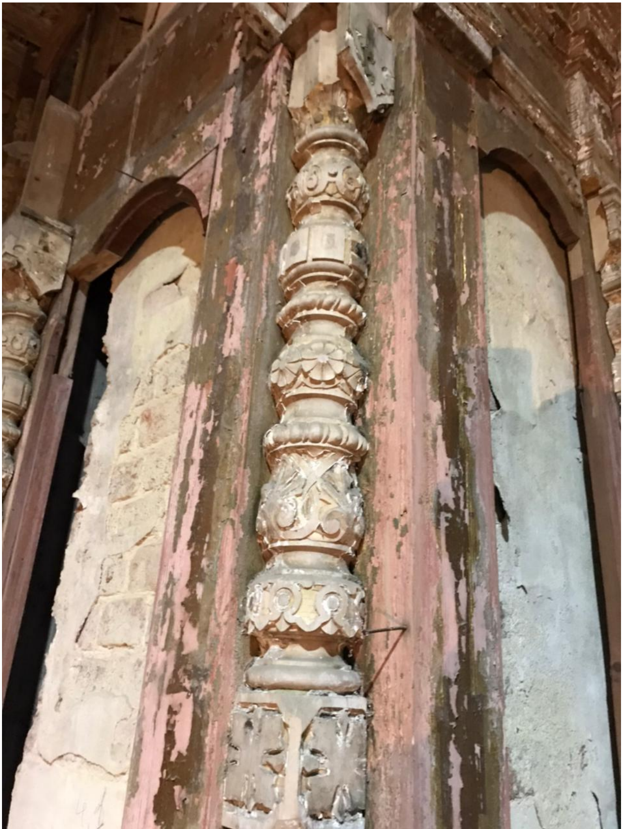
Фото 30. Фотофиксация сохранившихся деталей иконостаса в трапезной.
